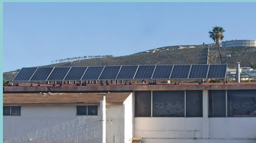
Figura 77a. Paneles solares instalados en la FCM, sobre el edificio E14.
