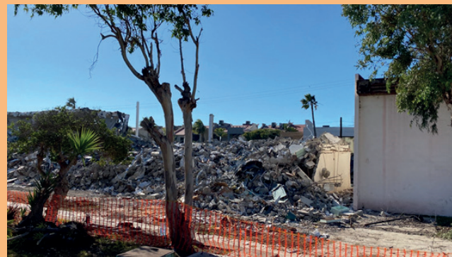
Figura 47. Escombros del antiguo edificio E15.
